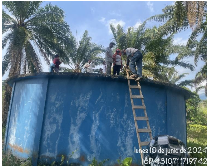
Ilustración 6. Tanque de almacenamiento de 45000 galones.
