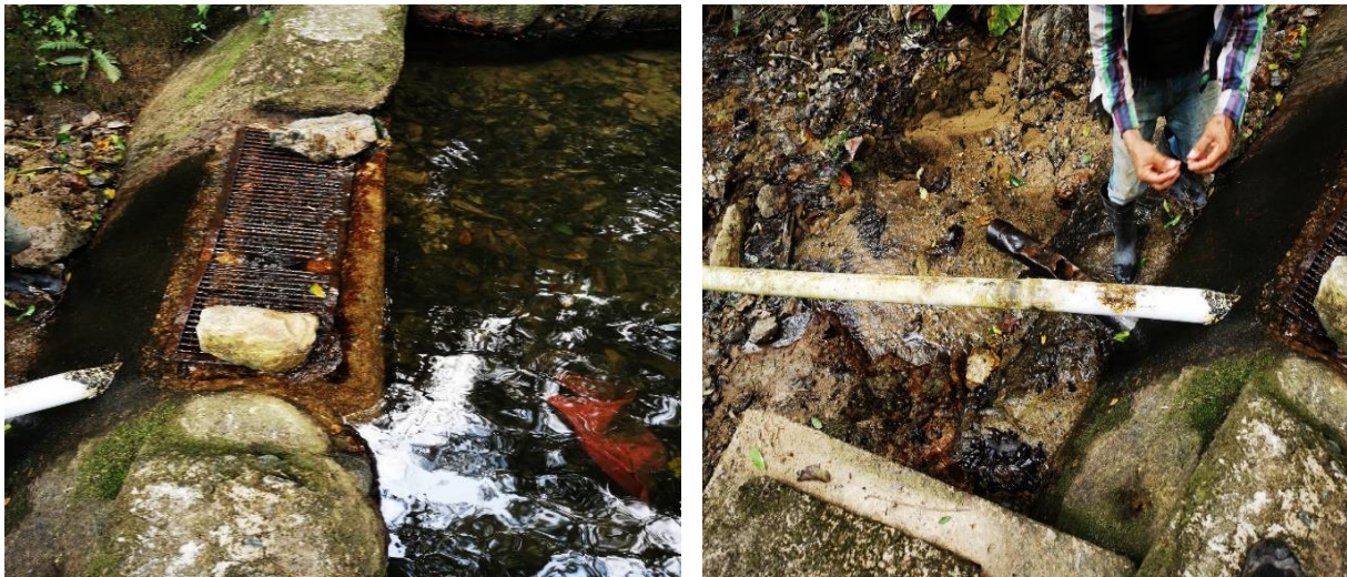
Ilustración 7. Rejilla en mal estado se observa que no hay rebose de agua.
