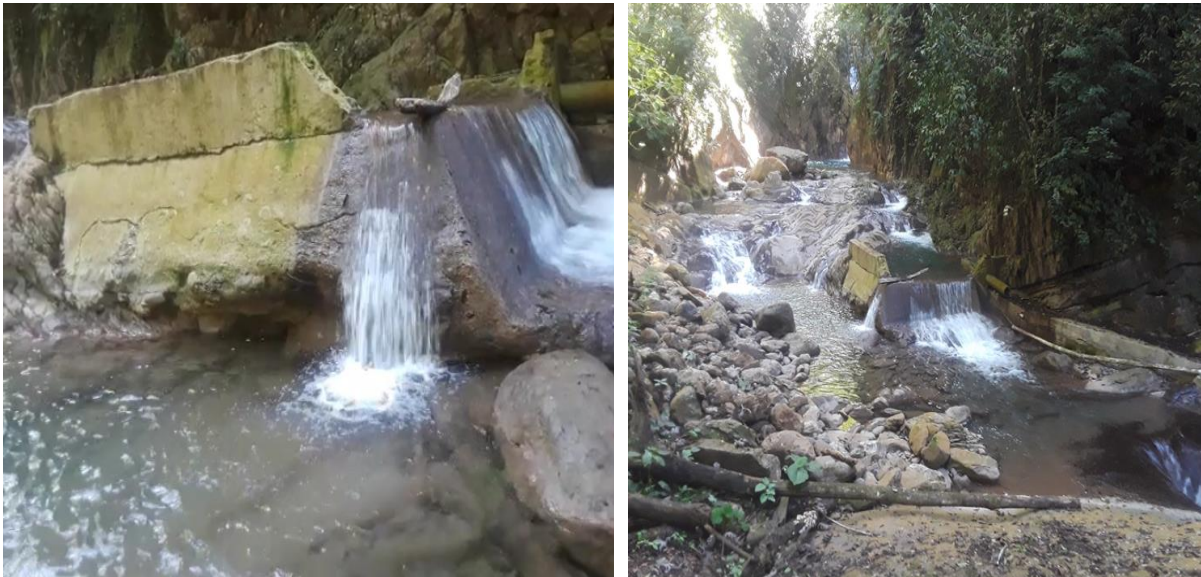
Ilustración 3. Socavación de cimientos y captación del caudal
