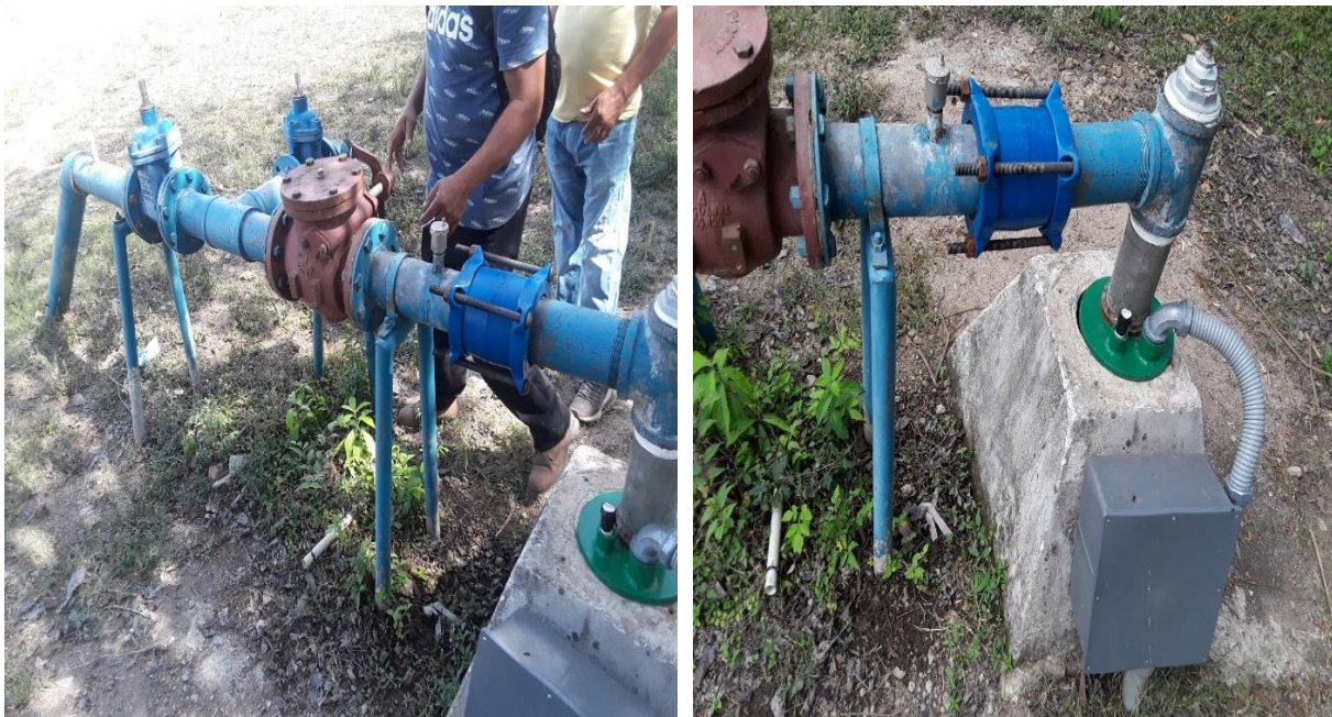
Ilustración 8. Estación de bombeo en mal estado
