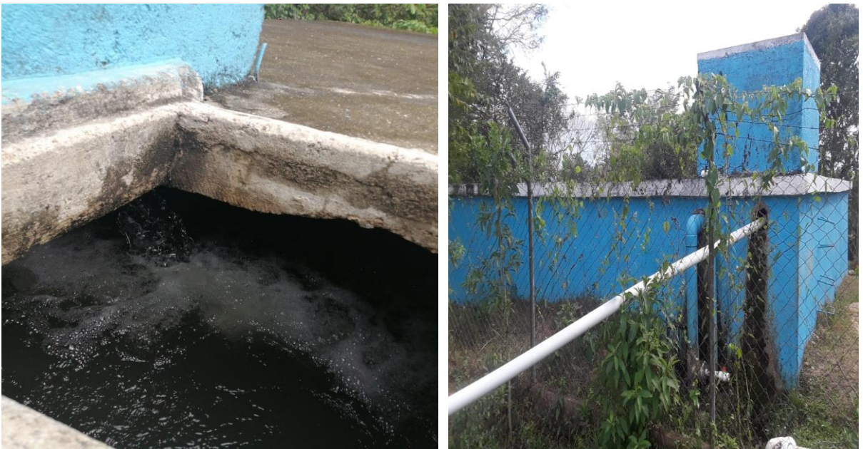
Ilustración 7. Sitio de tanque de almacenamiento
