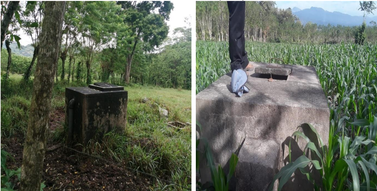
Ilustración 5. Estado actual de los tanques rompe cargas
