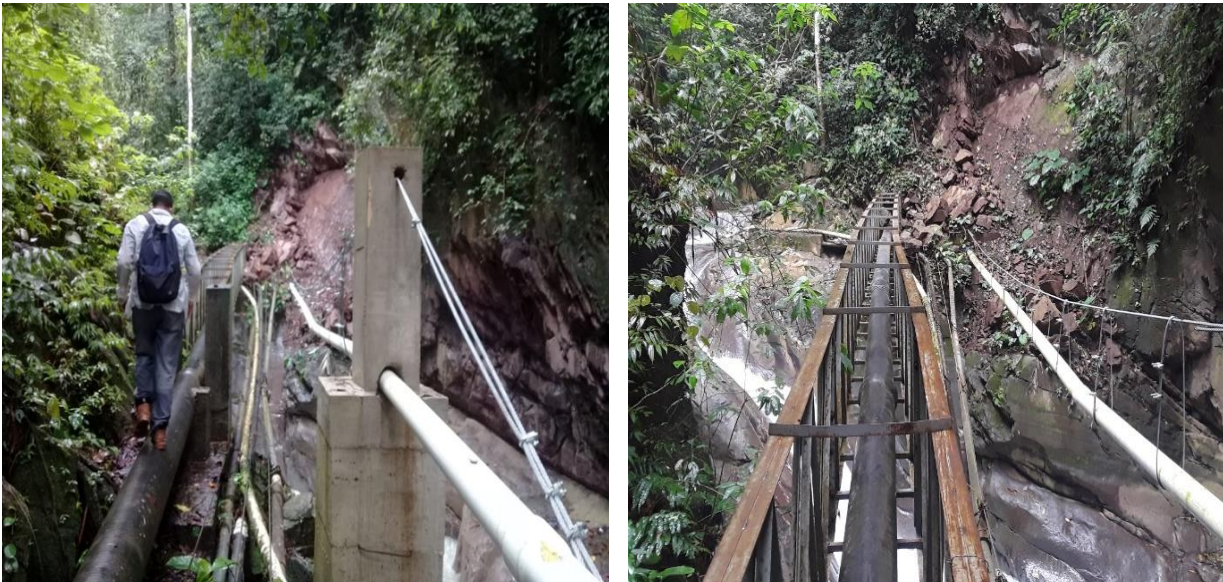
Ilustración 4. Cruce aéreo y anclaje
