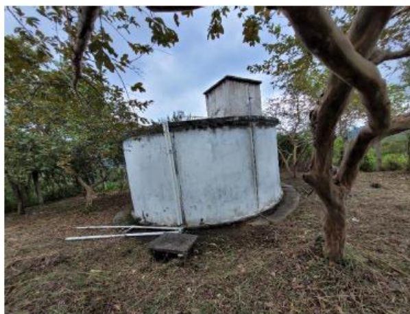
Fotografía 2: Tanque de Almacenamiento de Agua de Planes de Italia
