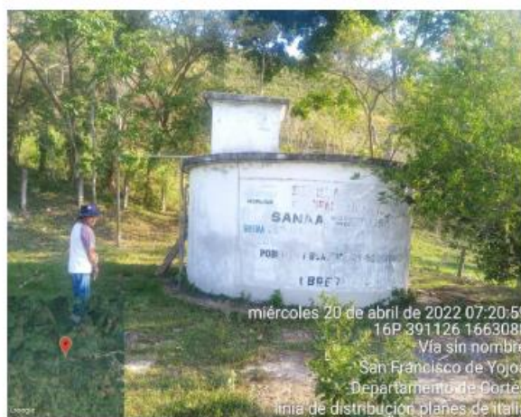
Fotografía 5: Tanque de Almacenamiento de Agua de Caleras
