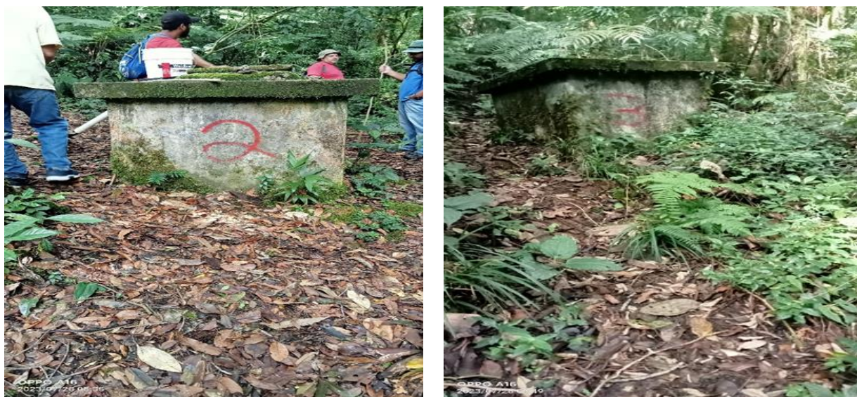
Ilustración 6. Rompe cargas del Subproyecto Existente
