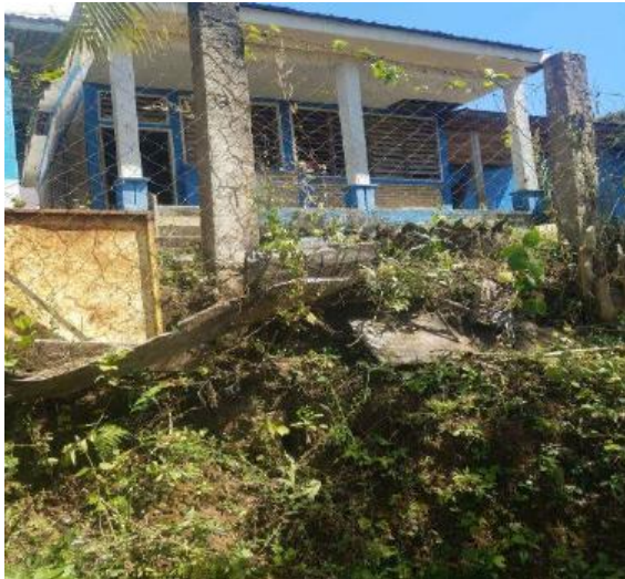
Ilustración 12. Cerco de malla ciclón dañado
