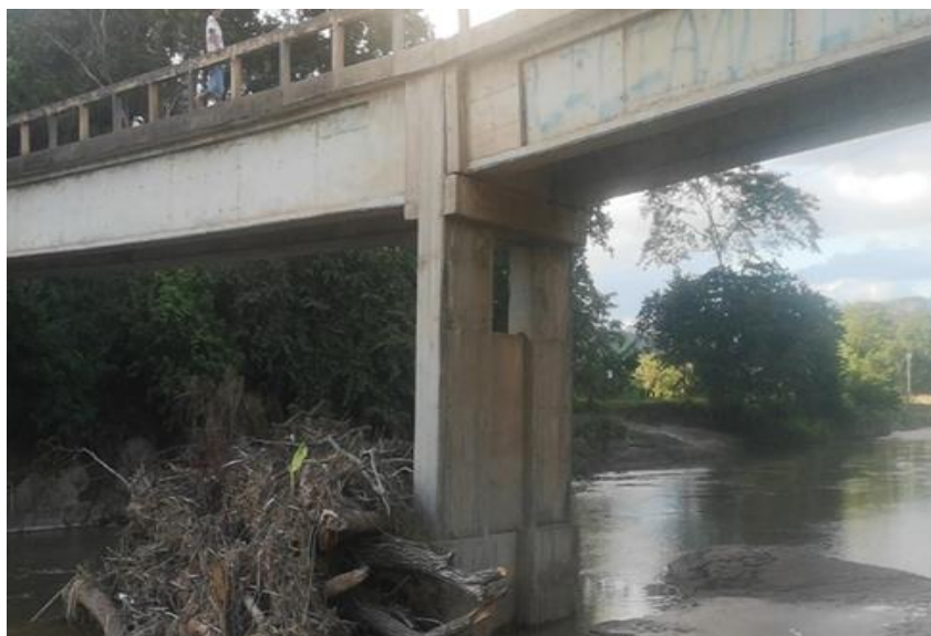
Ilustración 10. Afectaciones por arrastre de escombros y árboles.
