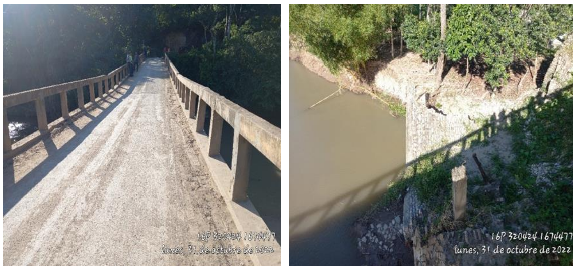
Ilustración 9. Afectaciones en la estructura y longitud del puente.
