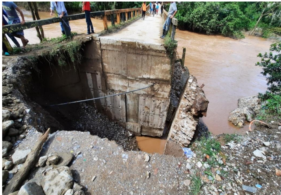
Ilustración 5. Afectaciones a la aproximación socavada
