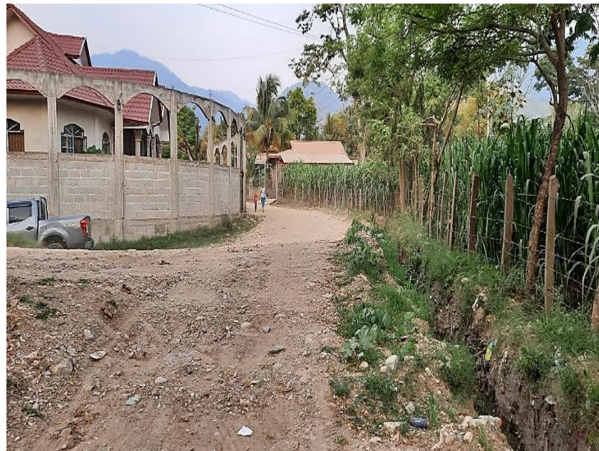
Ilustración 44. Vista del acceso a la aproximación del lado Este desde la ubicación del nuevo estribo propuesto.
