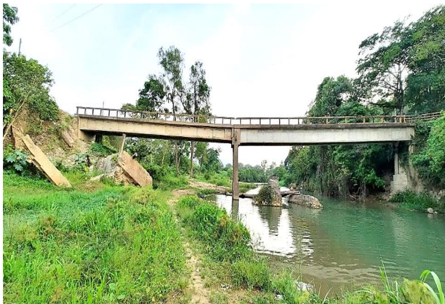
Ilustración 8. Vista desde aguas debajo de la estructura dañada.
