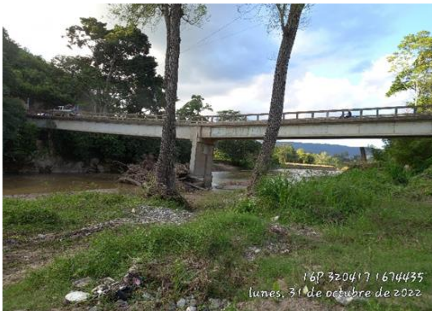
Ilustración 11. Afectaciones de la pilastra y la loza del puente.
