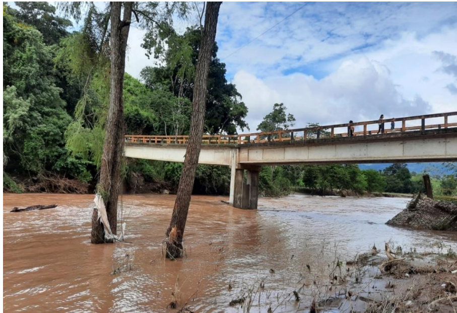
Ilustración 4. Afectaciones imagen captada 24 horas después del paso de Iota
