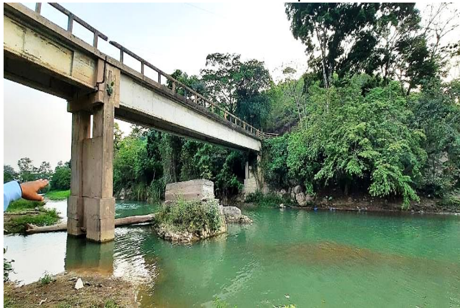
Ilustración 7. Perspectiva desde la ribera Este del río en donde se observa la falla tanto en la superestructura como en la subestructura.
