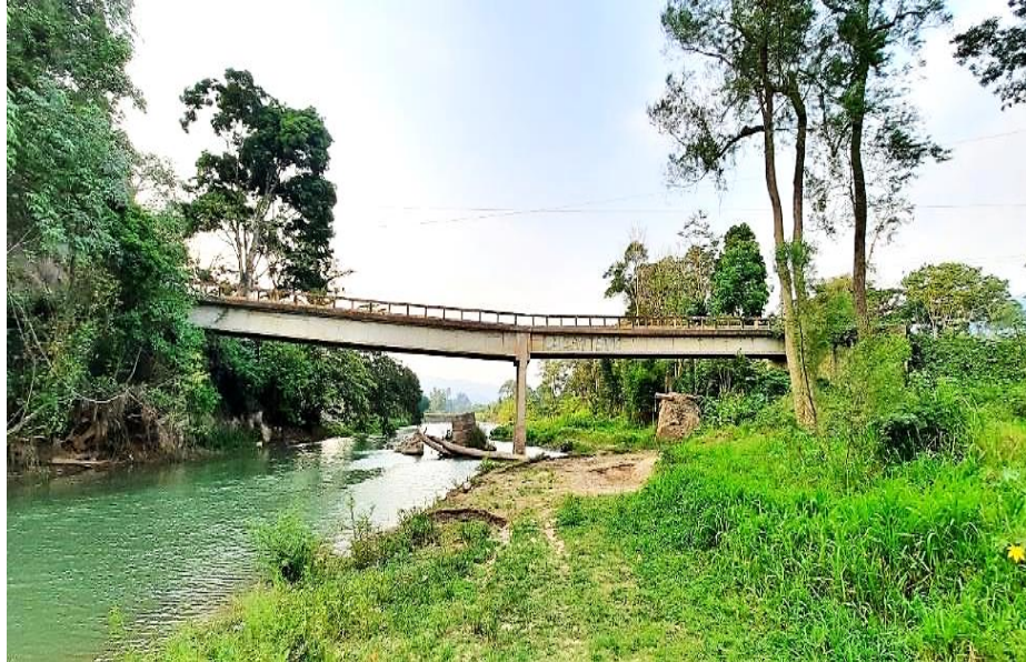
Ilustración 6. Vista del estado actual del puente existente (observado desde aguas arriba) en donde se observa el asentamiento de la pilastra.
