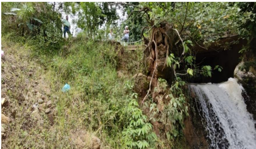
Socavación ala apoyo de la caja puente
