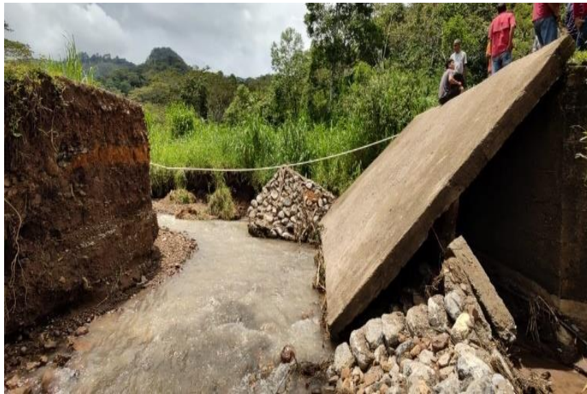
Ilustración 3. Afectaciones en la superestructura del puente.
