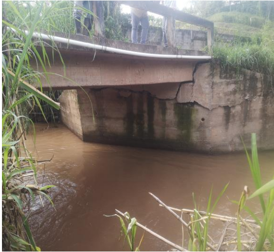
Daños de estribo de entrada
