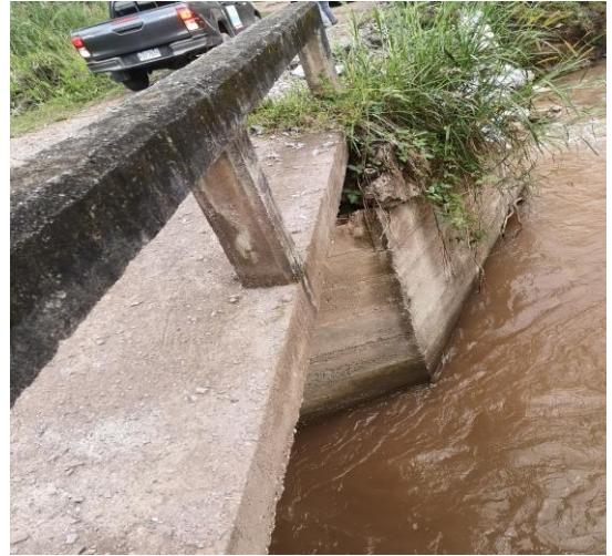
Daños de estribo de salida
