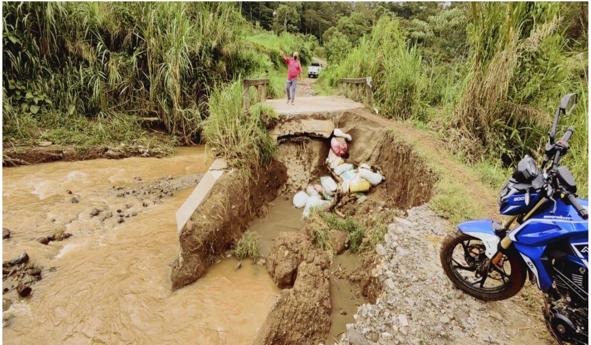
Ilustración 3. Daños a la estructura existente por el paso de las tormentas Eta e Iota.
