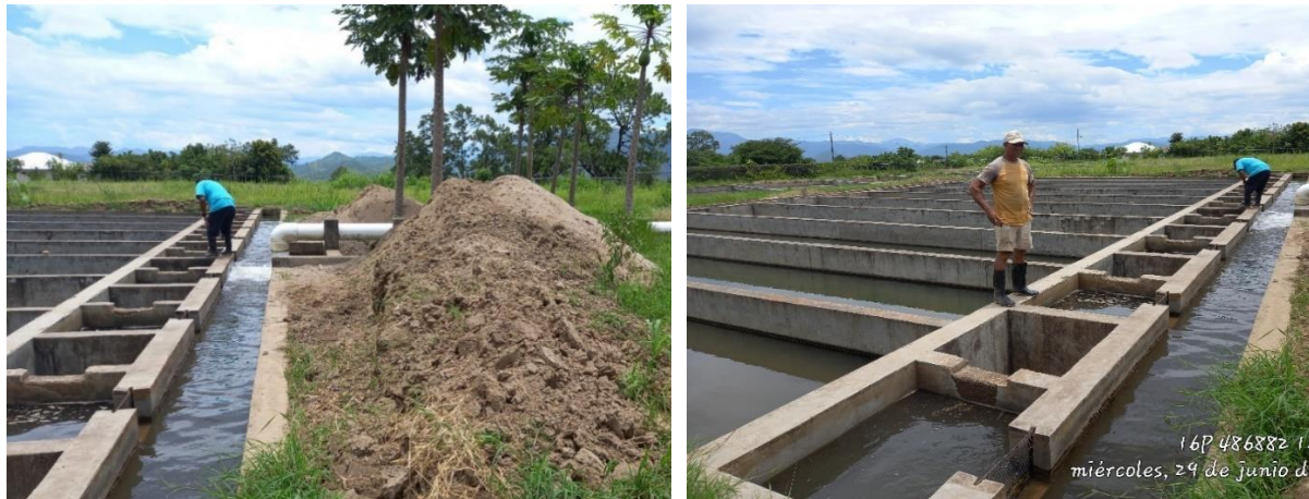
Ilustración 7. Planta de tratamiento desarenadores
